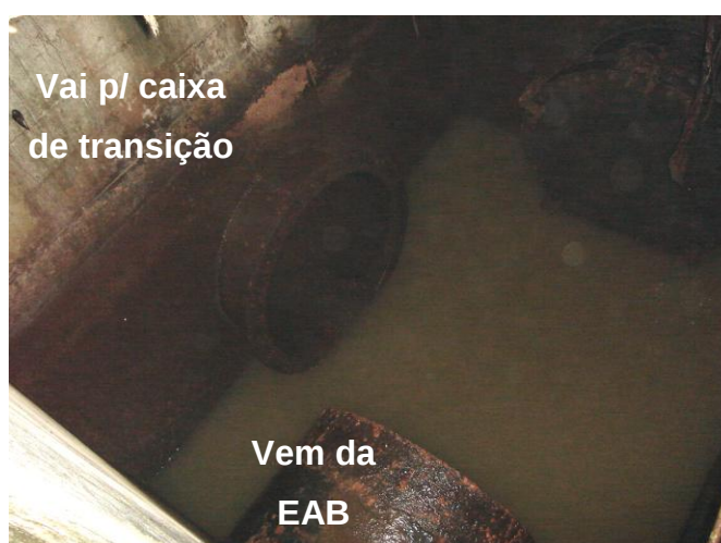
Fotografia 23: Caixa de desvio da adutora de 1.500 mm
