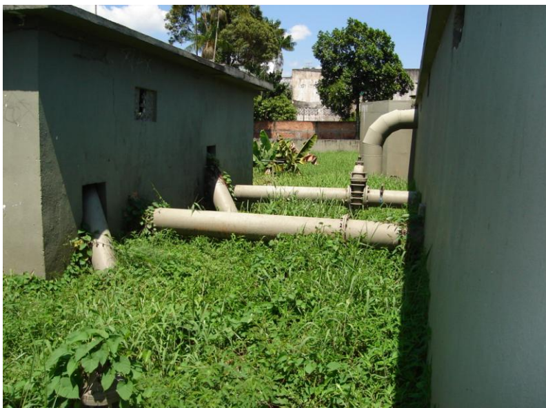
Fotografia 70: Casa de bombas – Poço 4º Setor (Desativado)
