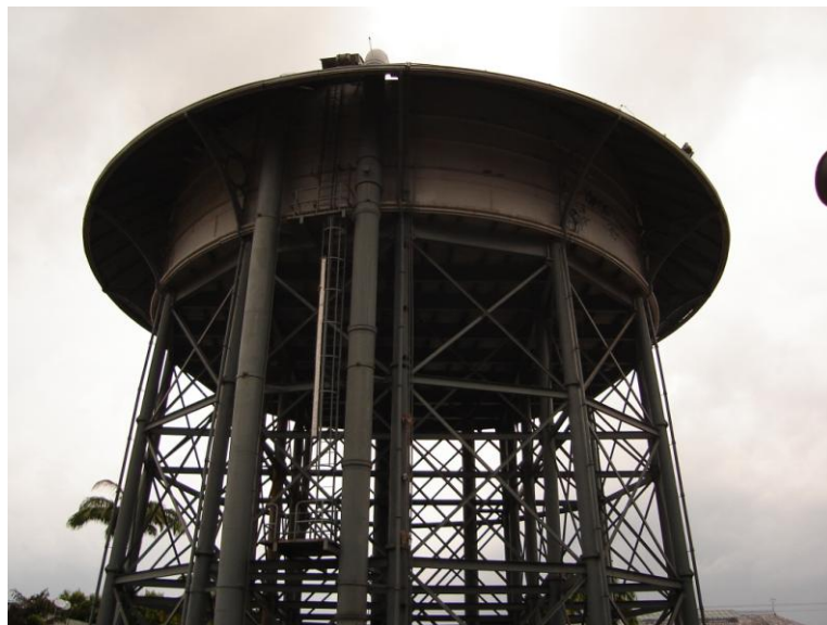
Fotografia 56: Reservatório Elevado ETA São Braz – 6º Setor
