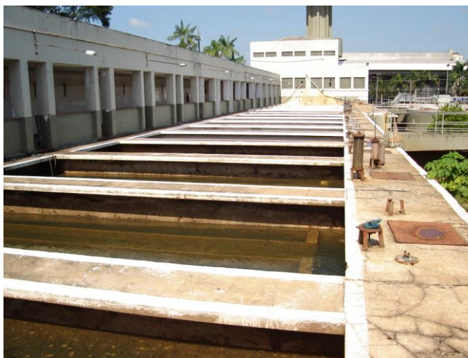
Fotografia 49: Filtros de areia da ETA 5º Setor
