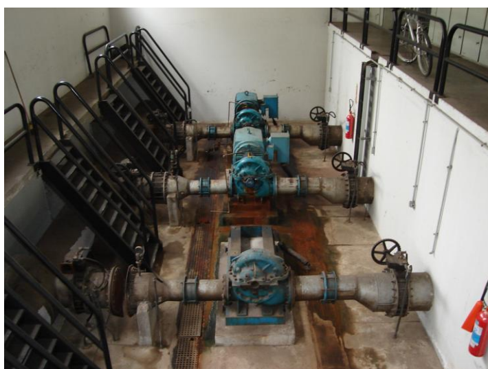
Fotografia 55: Casa de Bombas EAT São Braz
