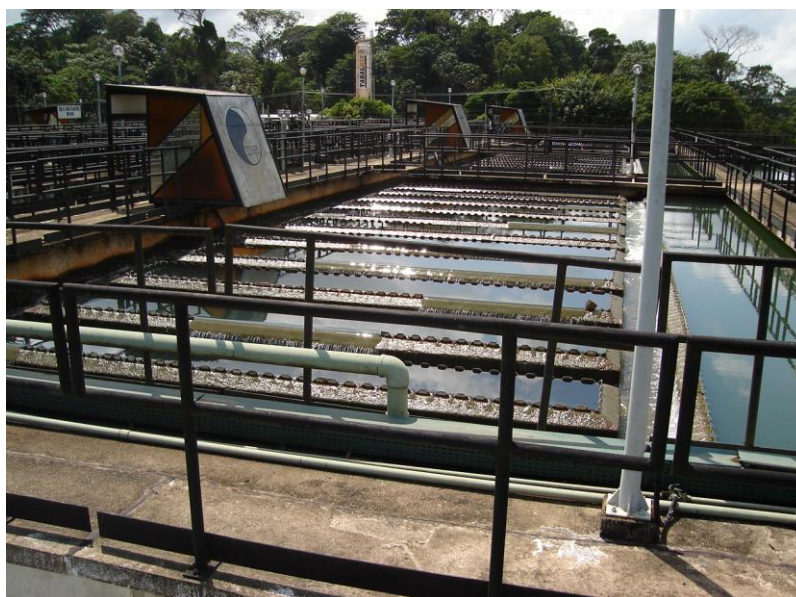
Fotografia 41: Decantadores ETA Bolonha
