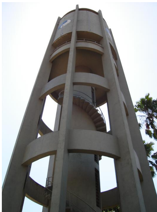
Fotografia 67: Reservatório apoiado de 4º Setor de abastecimento
