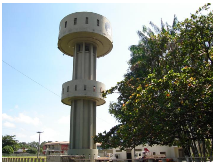
Fotografia 51: Reservatório elevado ETA 5º Setor
