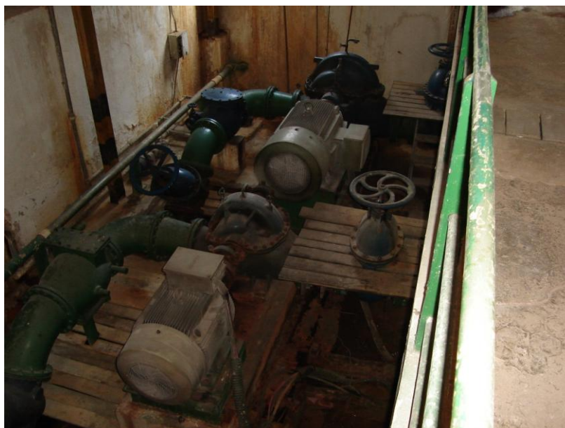
Fotografia 52: – Casa de Bombas da EAT 5º Setor
