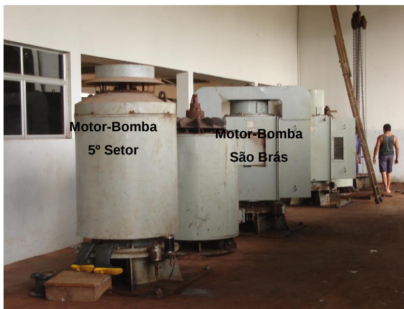
Fotografia 35: Conjuntos Motor-Bomba da EAB Utinga
