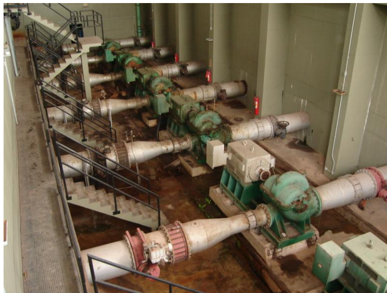
Fotografia 46: Casa de Bombas da EAT Bolonha
