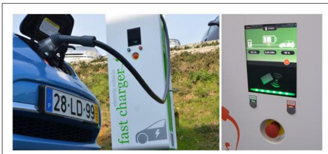
Figura 2.3 – Estação de Carregamento Rápido em Corrente Contínua.
