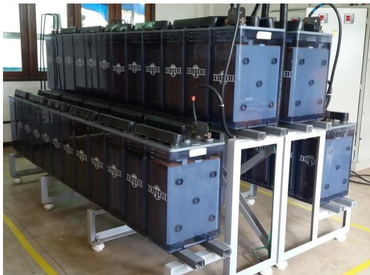
Figura 1.16 – Sistema de armazenamento constituído por dois bancos de baterias.
