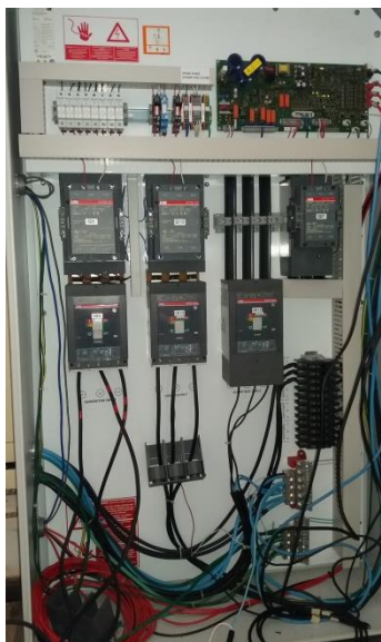
Figura 1.17 – Quadro de distribuição e comando Multicluster Box .
