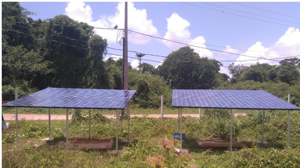
Figura 1.7 – GFV-06 e GFV-07 contendo os módulos da Kyocera
