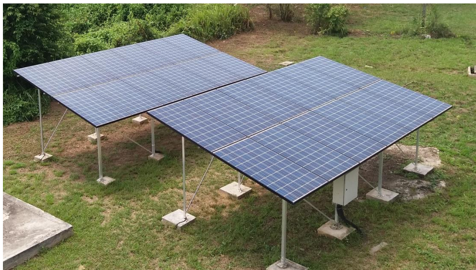
Figura 1.6 – GFV-04 e GFV-05 contendo os módulos da Kyocera.
