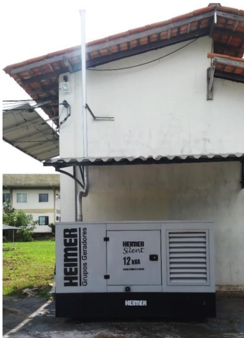
Figura 1.8 – Grupo gerador a diesel.
