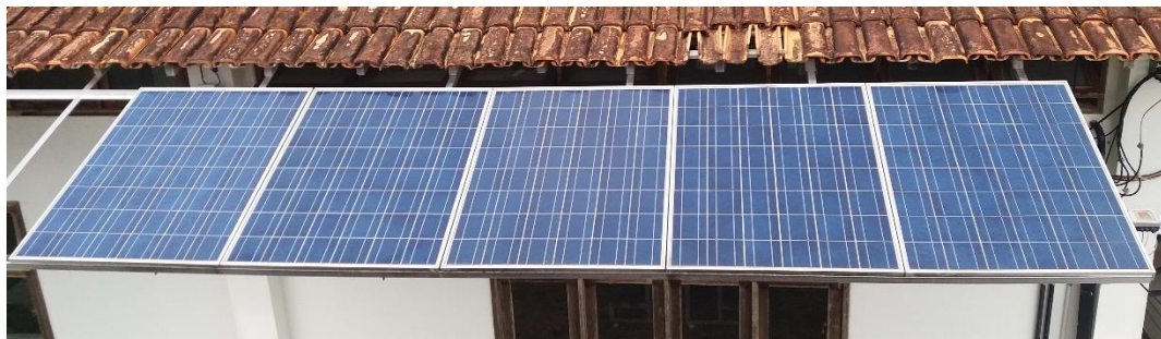
Figura 1.4 – GFV-01 contendo os módulos da Yingli de 185 Wp.
