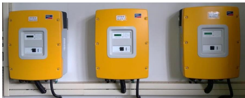
Figura 1.9 – Inversores Sunny Island 4548-US instalados.
