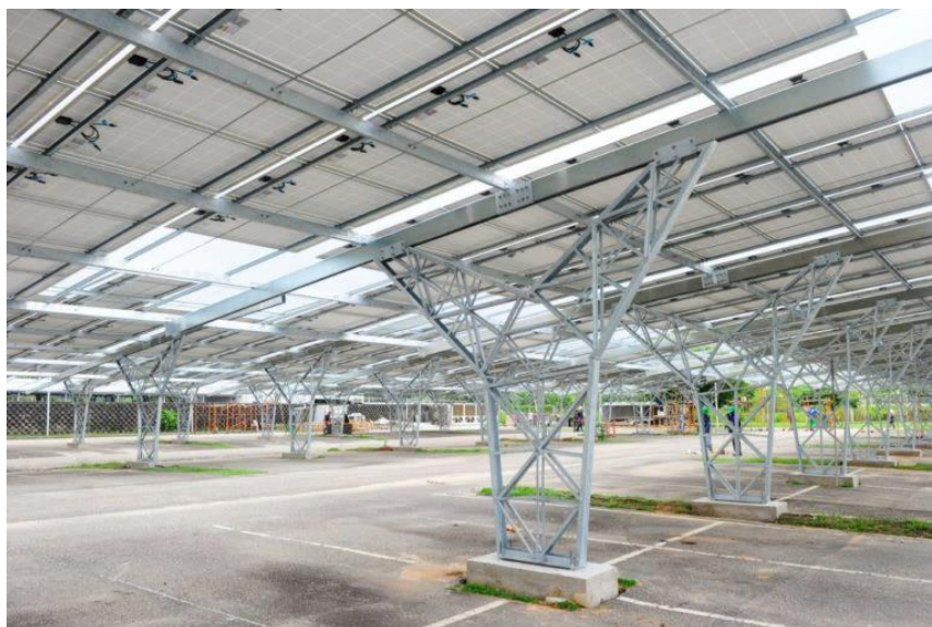
Figura 9 - Módulos fotovoltaicos instalados no estacionamento do Hangar, em Belém do Pará.
