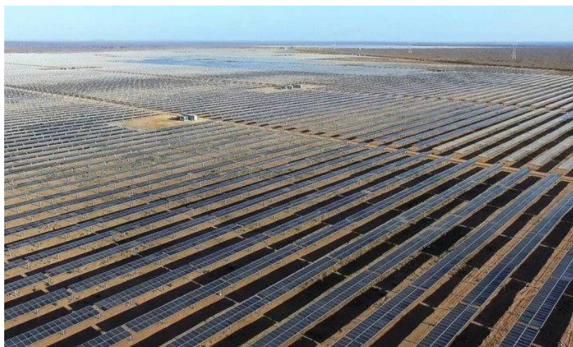
Figura 5 - Parque solar Nova Olinda.
