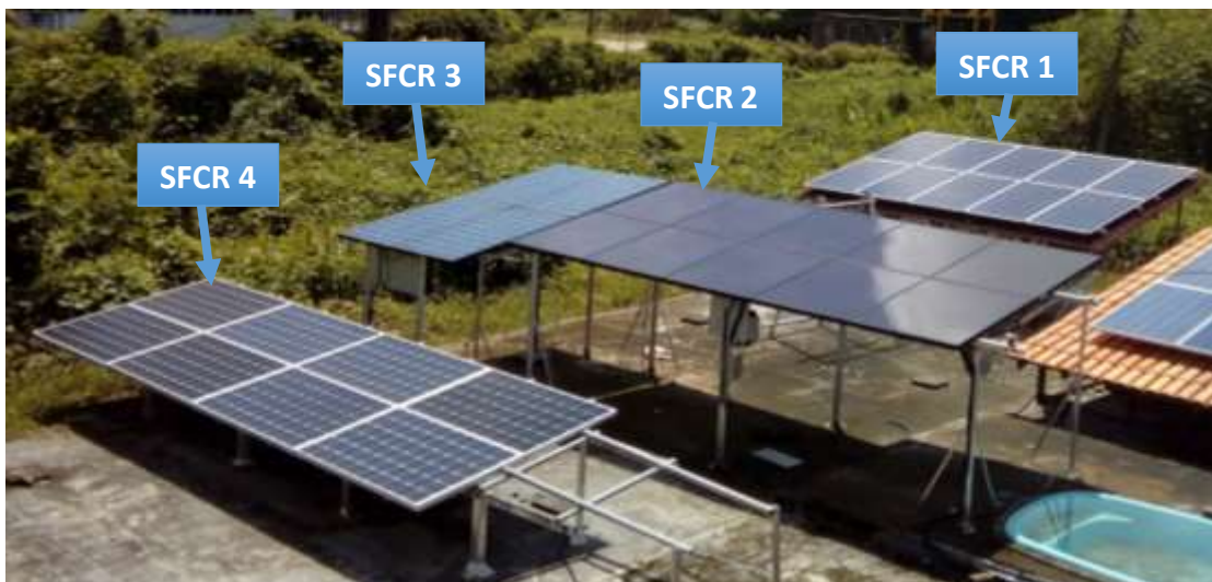
Figura 2.6 – Vista geral dos geradores fotovoltaicos. (Fonte: Elaborado pelo autor)
