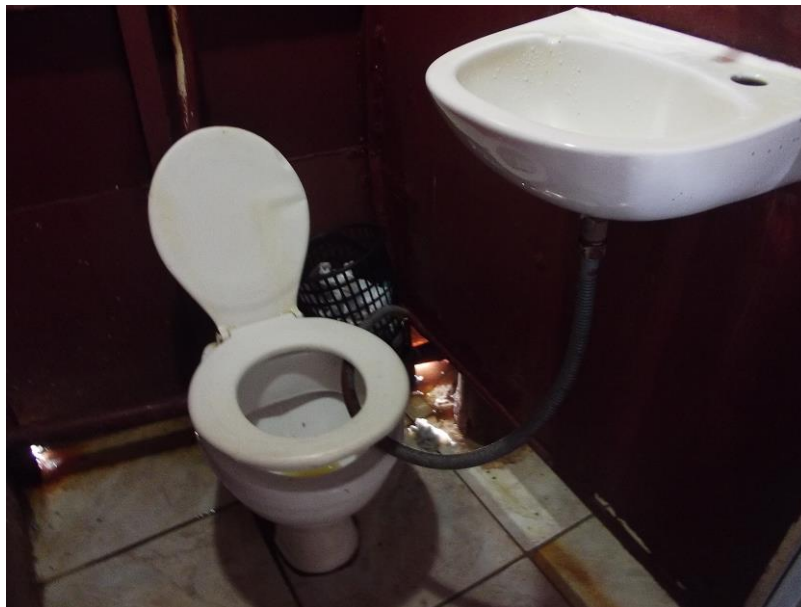
Figura 26 - Infraestrutura interna do banheiro do navio
