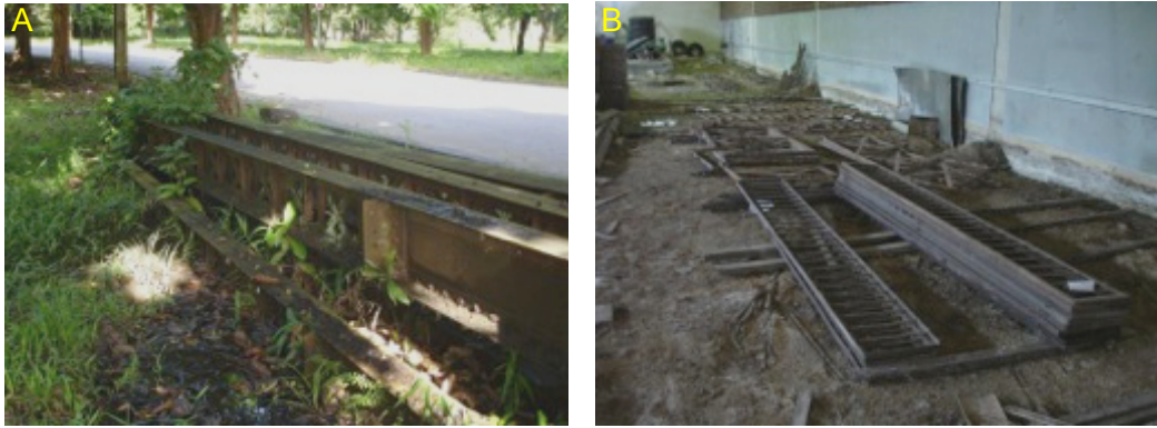
Figura 16 - Peças do antigo chalé de ferro da IOEPA expostas à constante precipitações (A), e expostas à ambiente de elevada umidade (B)
