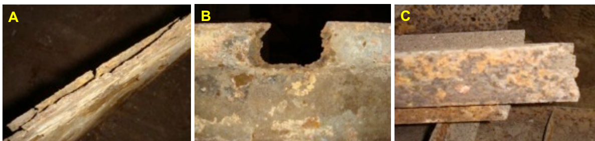
Figura 19 - Peças de vedação do antigo chalé de ferro da IOEPA com diminuição de espessura (A); perda de partes (B); e fratura (C).
