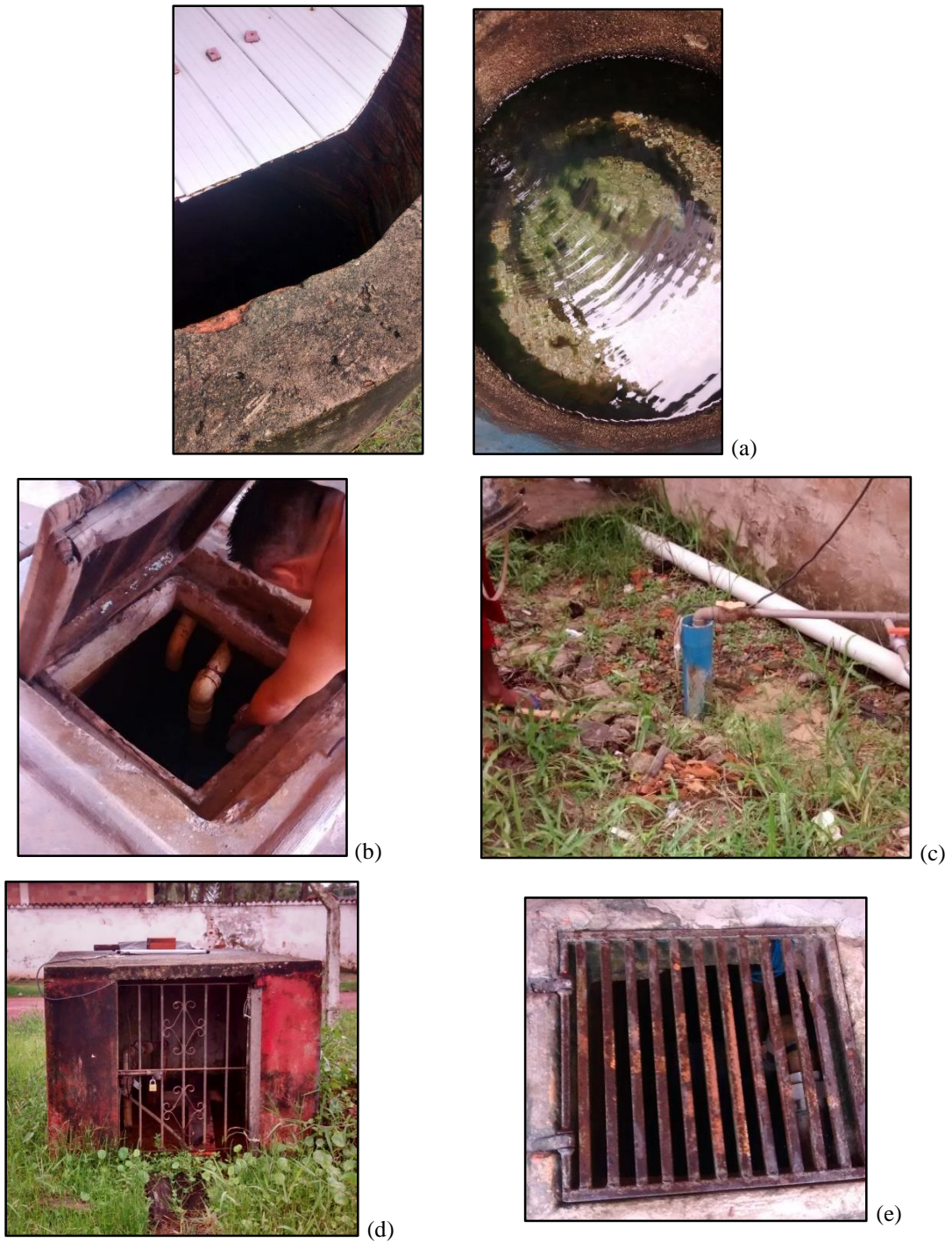
Figura 9- (a) Poço tipo amazonas (AMSAL15); (b) Poço tubular PTSAL16; (c) Poço tubular PTSAL18; (d) Poço tubular PTSAL19; (e) Poço tubular (PTSAL20).
