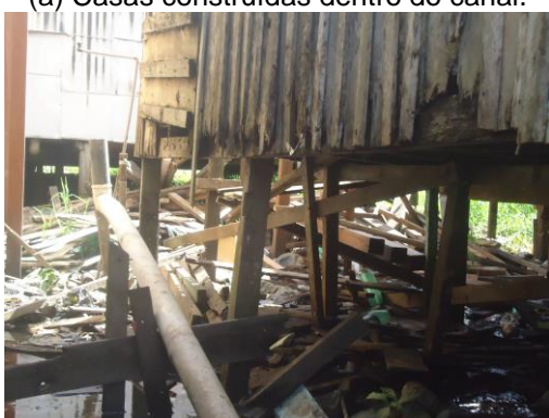
(c) Resíduos sólidos acumulados dentro do canal em baixo das residências.
