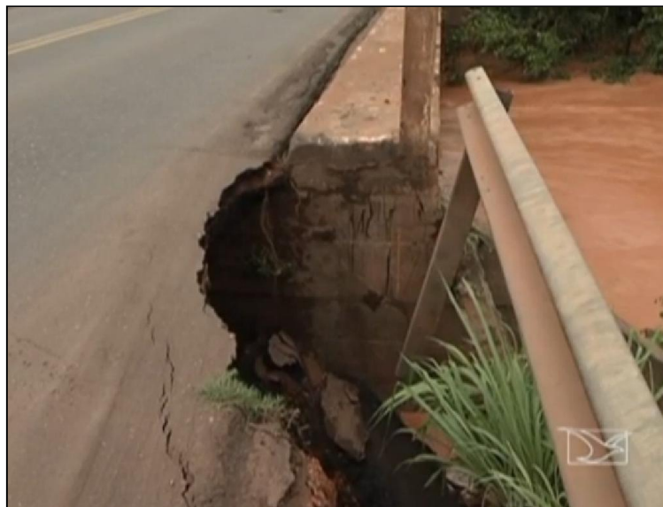
Figura 30. Ponte danificada na BR-010.
