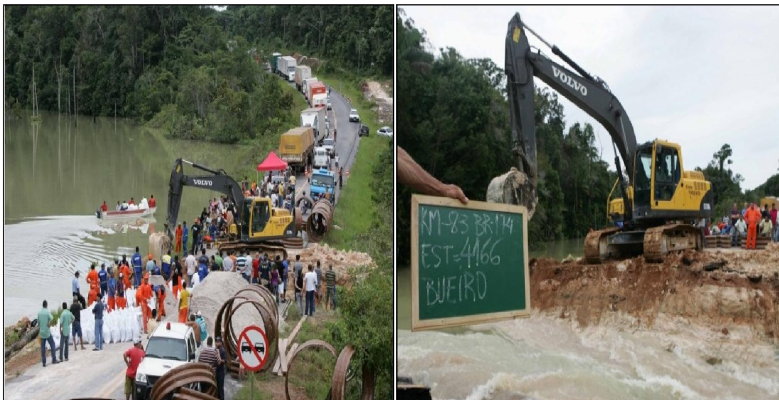
Figura 20. Interrupção da BR-174 por ruptura de galeria de tubos.
