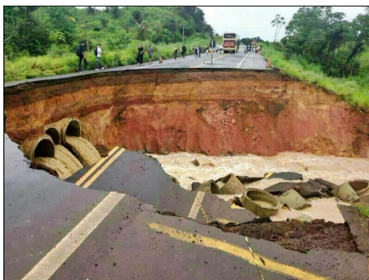
Figura 28. Interrupção da BR-010 em fevereiro de 2014.
