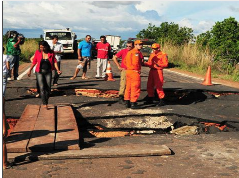
Figura 26. Rodovia BR-401. Ruptura de tubos.
