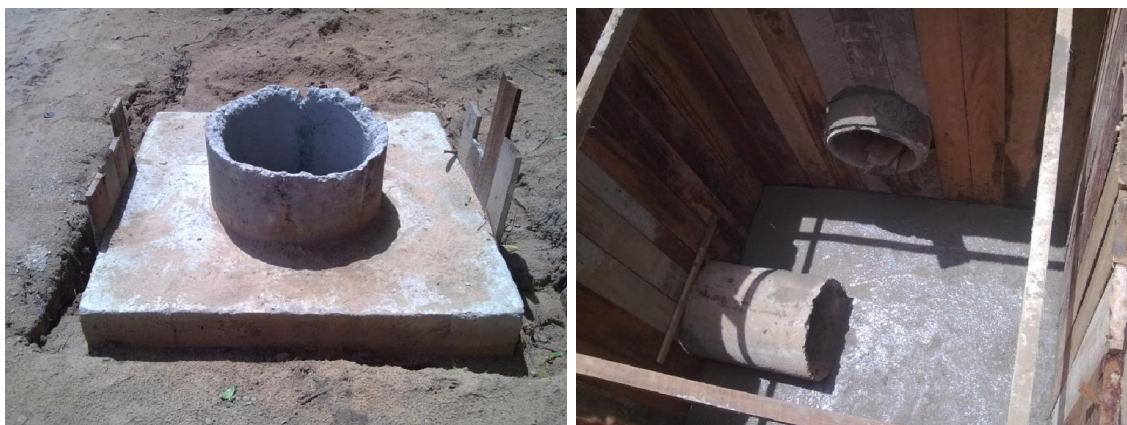
Figura 16. Caixas coletoras em obra de drenagem no município de Santa Isabel do Pará, PA.
