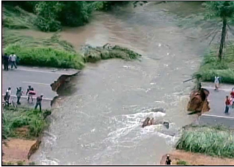
Figura 22. Interrupção da BR-010 em São Miguel do Guamá, Pará.
