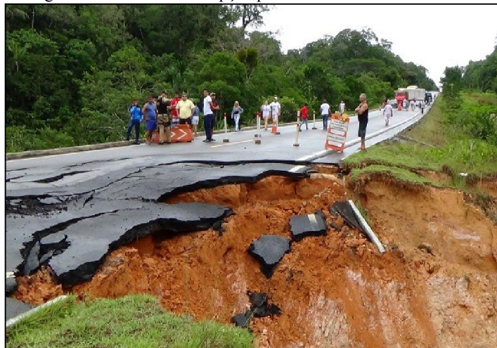
Figura 19. BR-174. Interrupção por erosão. 117 km de Manaus.
