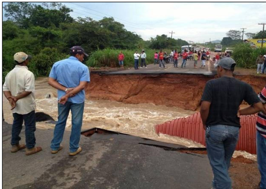
Figura 29. Bueiro colapsado na BR-155
