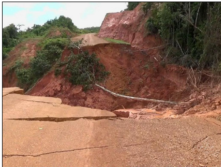
Figura 27. Interrupção da BR-230 por ruptura de tubos.
