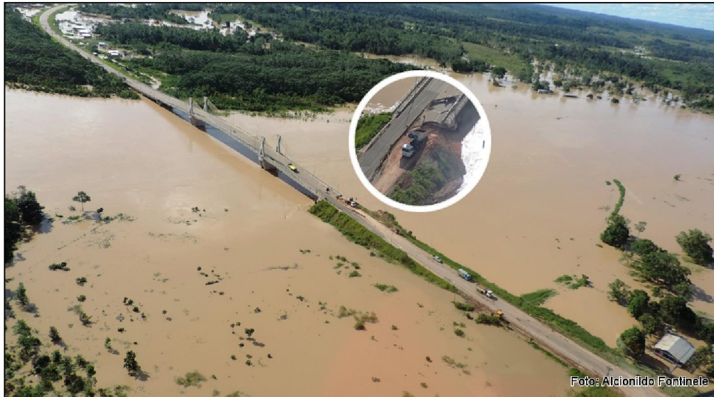
Figura 33. Ponte sobre o rio Tarauacá (AC) com danos em sua estrutura.
