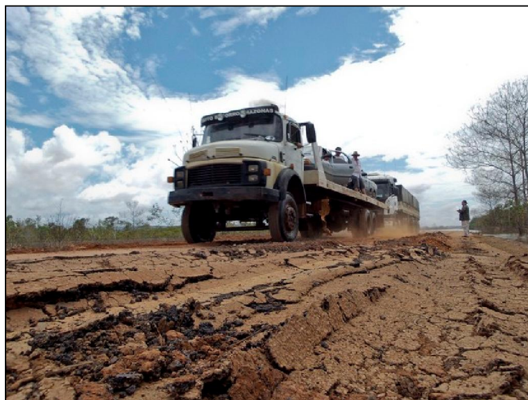
Figura 46. Danos à estrutura do pavimento na rodovia BR-364 após inundação de 2014.
