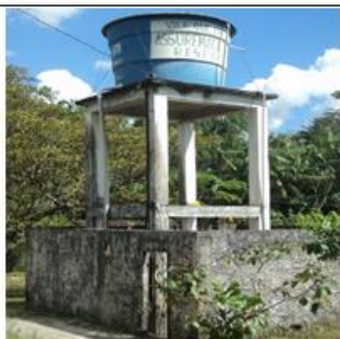
Foto 01 – Abastecimento de água construído pela Associação da RESEX
