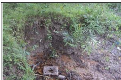
Foto 04 – Processos erosivos a margem do rio Vila Taquandeuá.
