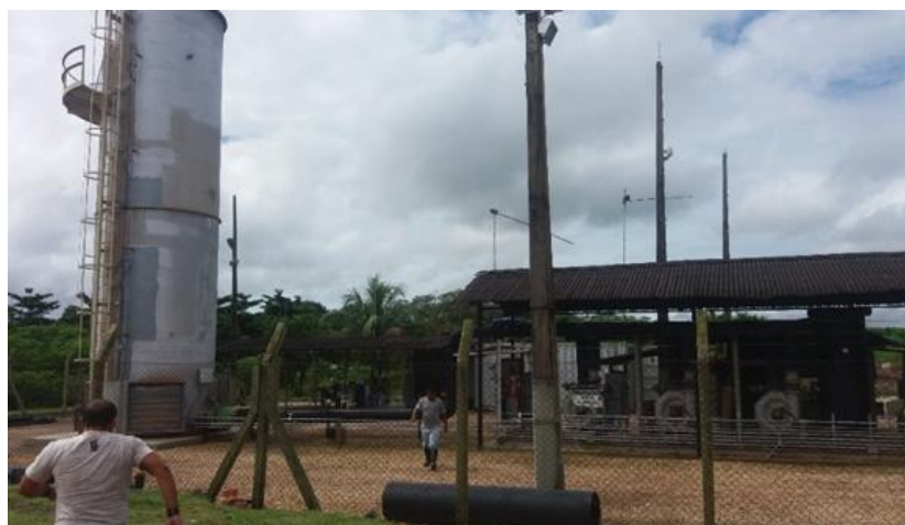
Figura 10 — Sistema de queima do biogás
