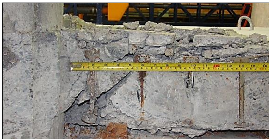
Figura 2.12 – Ruptura por punção com superfície de ruptura interna à região das armaduras (FERREIRA, 2010)
