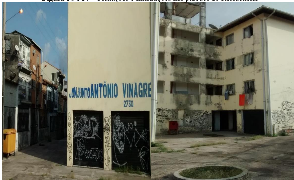
Figura 36 e 37 – Pichações e infiltrações nas paredes do Residencial
