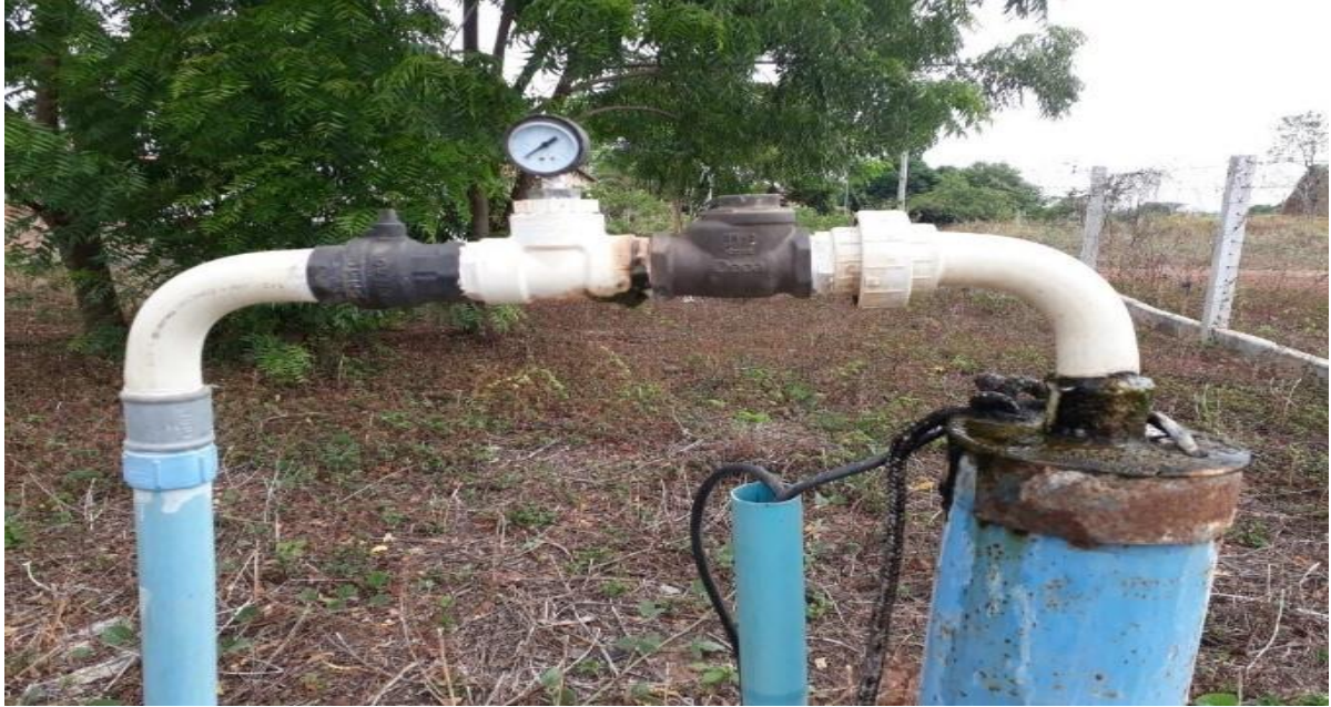
Figura 02 - Mostra alguns detalhes do poço fechado Fonte – Autora
