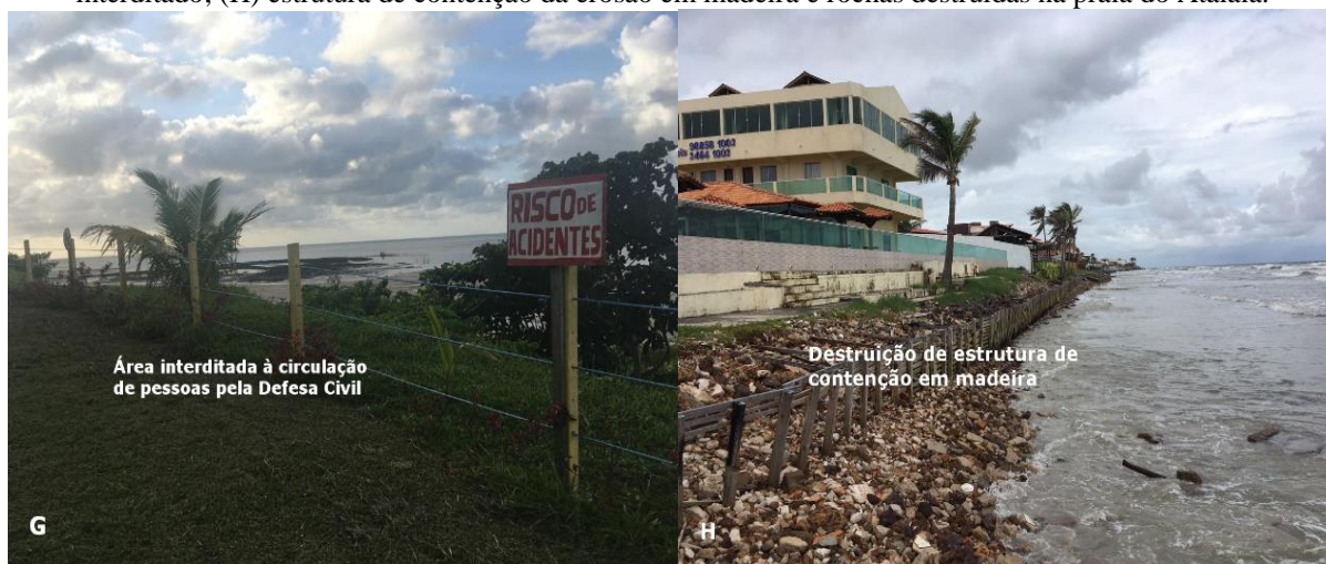
Figura 2.11- Medidas de contenção da erosão em Salinópolis: (G) parte central do Setor de Falésia Leste interditado; (H) estrutura de contenção da erosão em madeira e rochas destruídas na praia do Atalaia.
