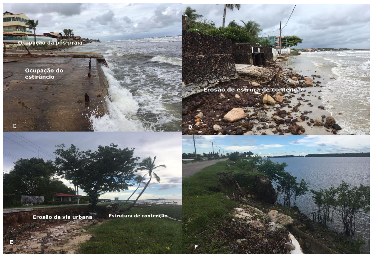
Figura 2.10- Ação das ondas e correntes longitudinais e de marés sobre estruturas artificiais: (C) Setor da praia do Atalaia, em Muito Alta Vulnerabilidade, sofrendo ataque das ondas; (D) Setor da praia do Farol Velho em Muito Alta vulnerabilidade, apresentando intenso processo erosivo; (E e F) Setor de Falésia Leste, a ação, principalmente das correntes de marés tem provocado erosão nas vias de circulação.
