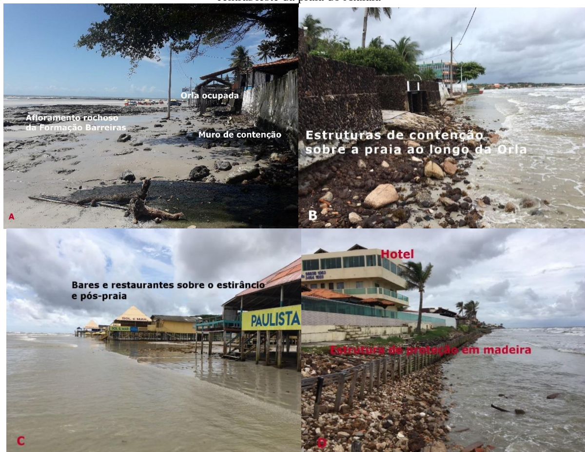
Figura 4.9- A) Setor central da Praia do farol Velho: muro de proteção sobre a pós-praia no plano a direita e afloramento de material rochoso devido a erosão da praia no plano de fundo; B) Setor central/oeste da praia do Farol velho: solapamento pelas ondas de estruturas de proteção residencial construídas sobre a pós-praia e estirâncio ao longo de toda costa; C) Setor central/oeste da praia do Atalaia: Restaurantes construídos sobre a pós-praia e estirâncio; D) Estrutura residencial de proteção contra erosão sendo ultrapassada pelas ondas no setor central/leste da praia do Atalaia
