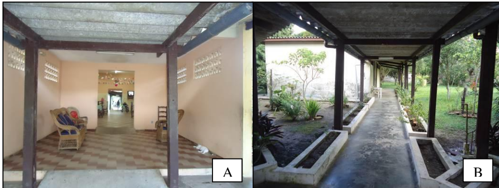
Figura 8. Área social: A - Corredor de divisão de alas ao lado refeitório e B- Divisão de alas para os quartos.
