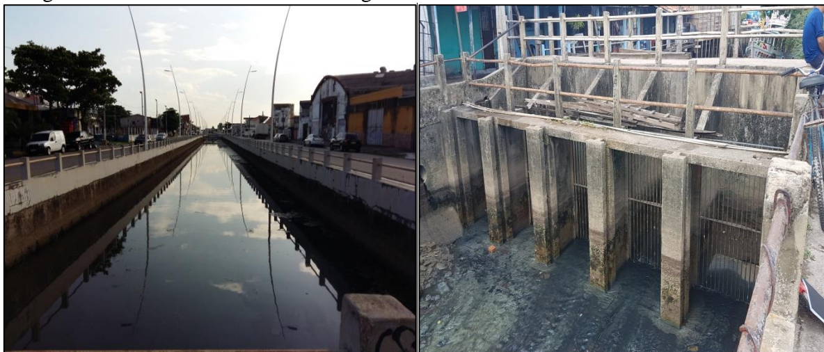
Fotografia 2 – Estruturas de macrodrenagem da microbacia da Tamandaré.
