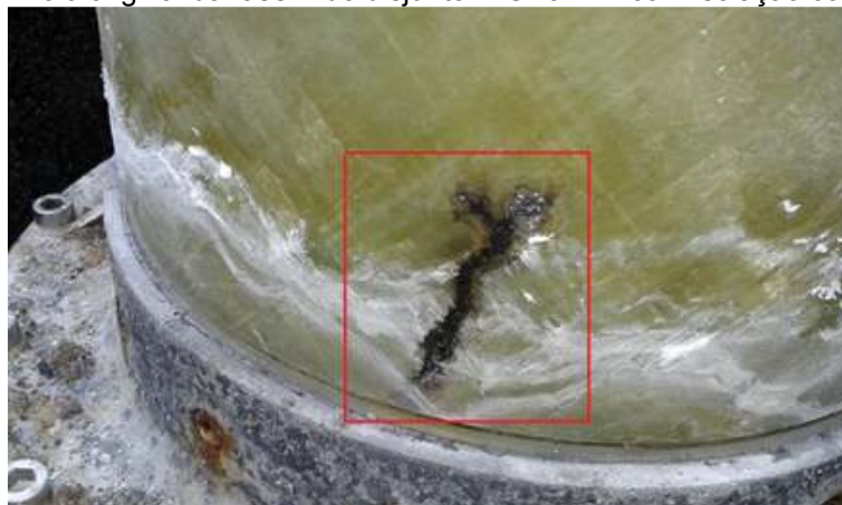
Figura 5.7 – Pólo original da fase B do disjuntor VCDJ2-12 com isolamento comprometida.
