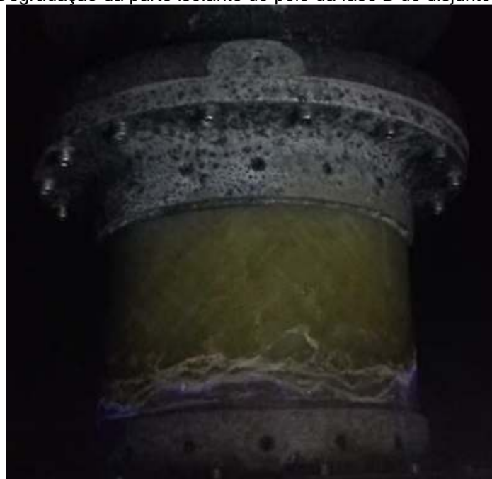
Figura 5.22 – Degradação da parte isolante do pólo da fase B do disjuntor VCDJ2-12.
