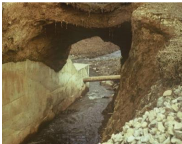
Figura 3 – Exemplo de barragem de mineração situada na República Checa rompida por erosão interna ( piping ).
