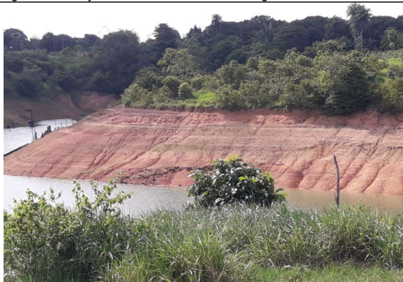
Processos erosivos laminares, lineares e com participação de solapamentos
