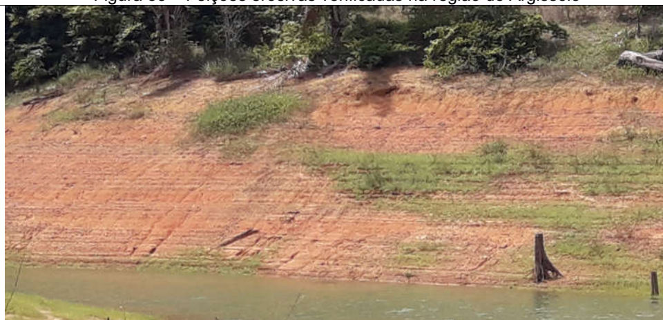
Processos erosivos laminares, lineares e com participação de solapamentos
