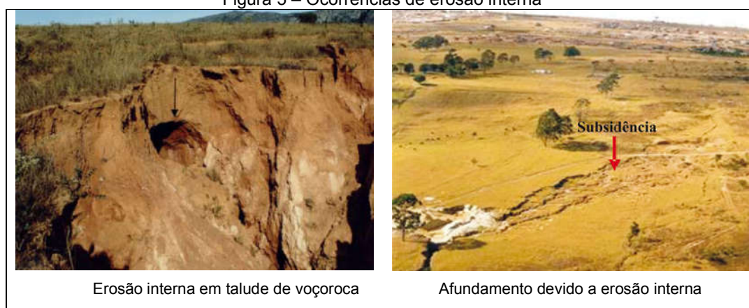
Figura 5 – Ocorrências de erosão interna
