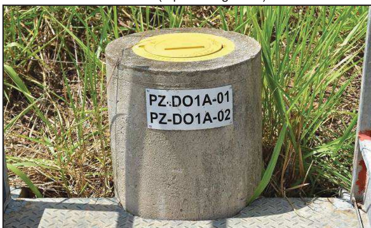
Figura 11 - Piezômetros de Tubo Aberto (Tipo Casagrande) DIQUE 01-A – BELO MONTE
