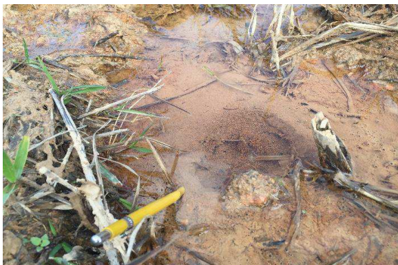
1.0 Identificação de canalículos com surgências de água.
