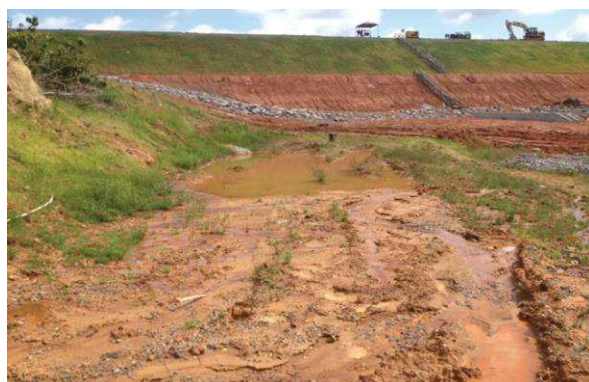
3.0 Identificação de surgência de água próximos ao dreno de pé e talude de escavação.
