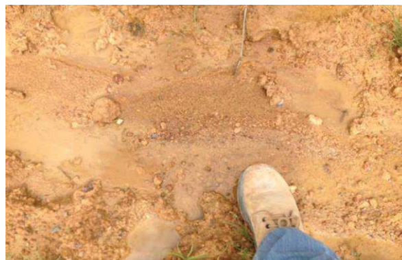
2.0 Identificação de surgência de água a jusante do Dique.
