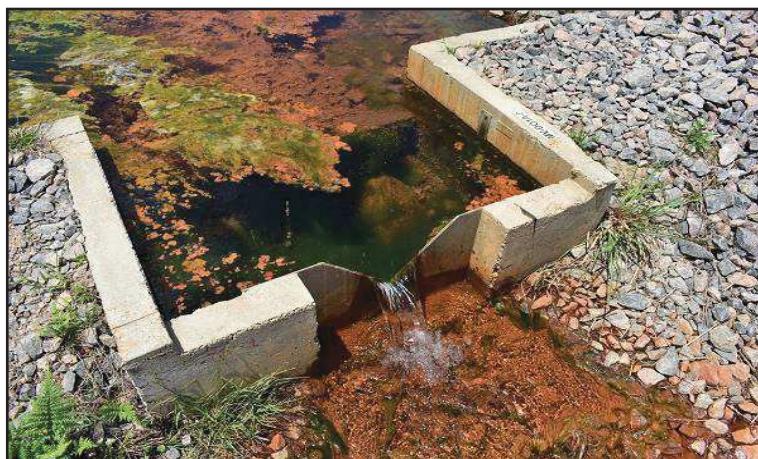
Figura 13 - Medidor de Vazão do tipo Triangular - DIQUE 01-A UHE – BELO MONTE
