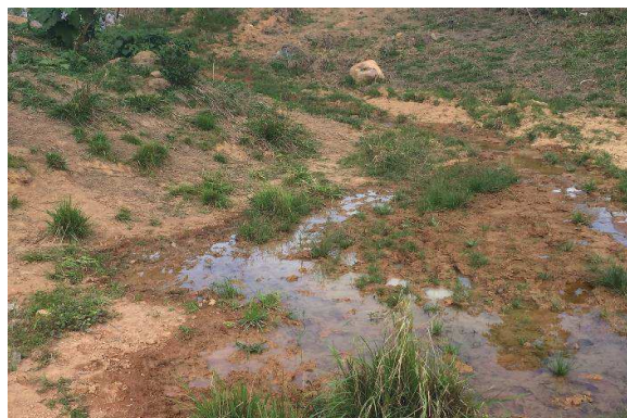
2.0 Identificação de surgência de água a jusante do Dique.
