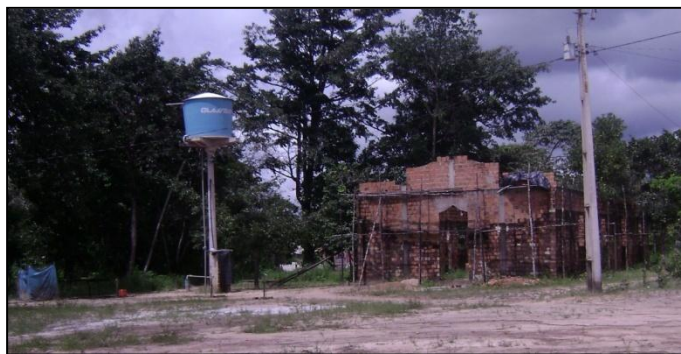
Foto 4: Poço artesiano e igreja católica em construção. Fonte: FERNANDES, Thiara, pesquisa de campo, abr/09.
