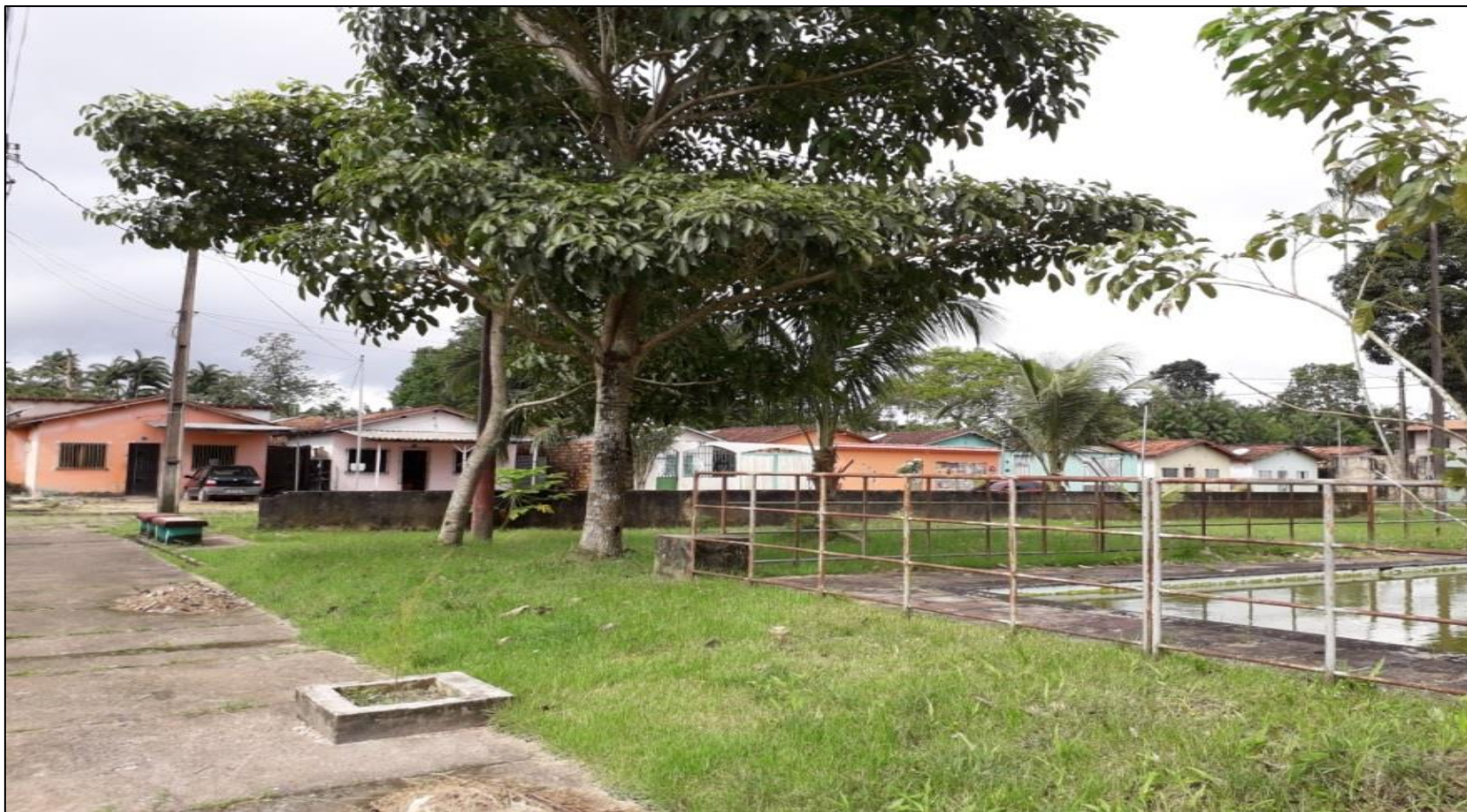
FOTOGRAFIA 18: A PISCINA DO RESIDENCIAL JARDIM JADER BARBALHO: a Comunidade não conseguiu mantê-la em condições de uso. FOTO: Marlon D'Oliveira Castro, março de 2019.
