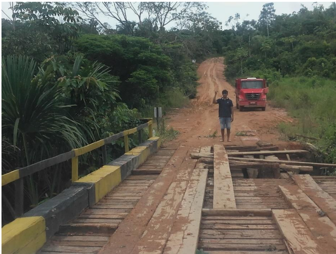
Figura 63: Ponte quebrada devido à má conservação da estrada, logo após o Km 180
