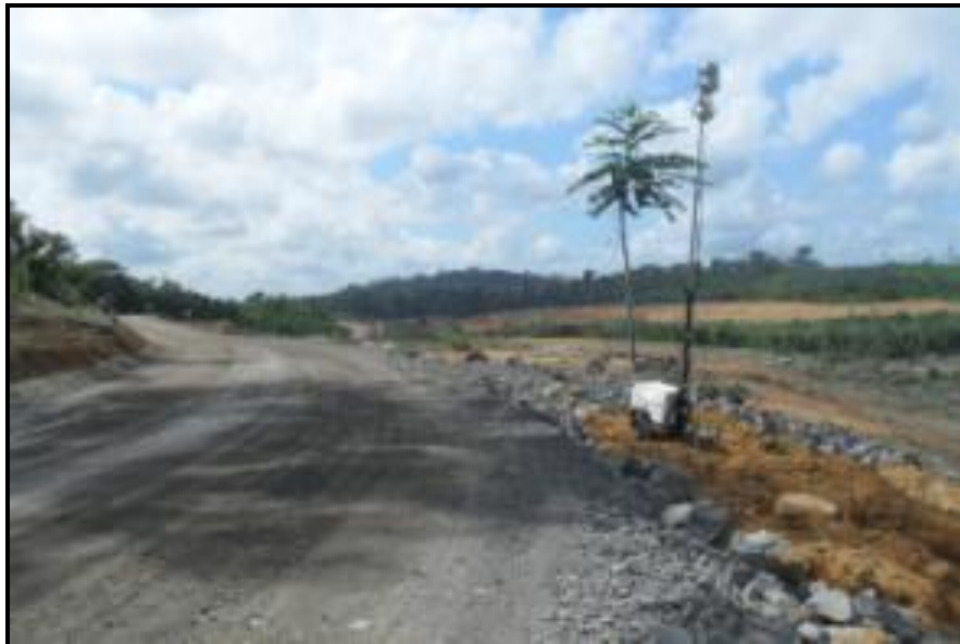
Figura 5 - Condições da estrada Travessão do km 27, via de acesso ao canteiro de obras.
