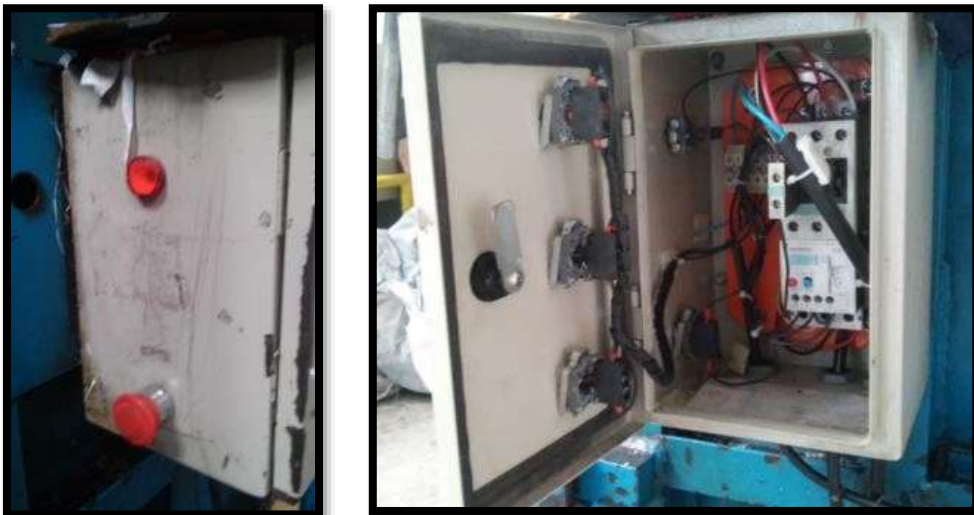
Fonte 4.6 - Quadro elétrico e comandos elétricos.
