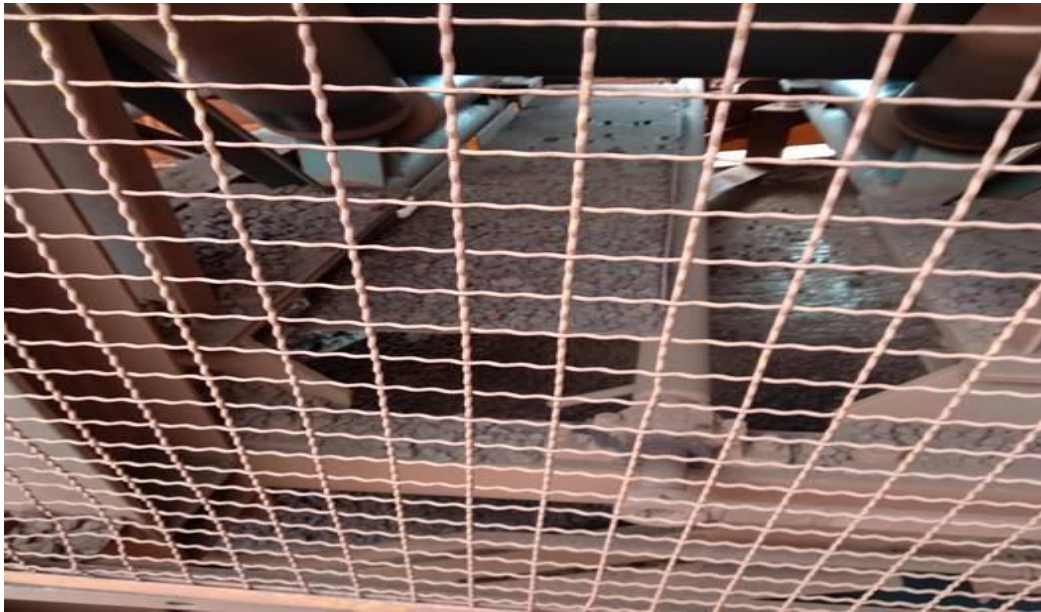
Figura 4.33 - Comprovação da causa atuação de detectora de rasgo por excesso de sujeira nas bandejas (verificações em campo do acúmulo de material nas chaves de rasgo tipo bandeja).
