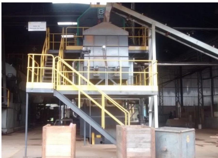
Figura 4.16 - Setor de geração de energia, através de vapor, da fábrica.
