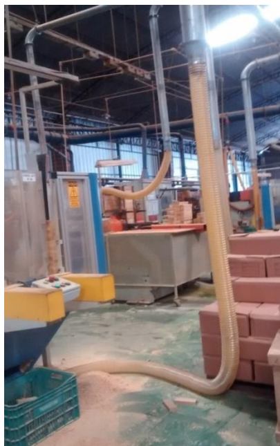
Figura 4.17 - Tubo de exaustão de serragem.
