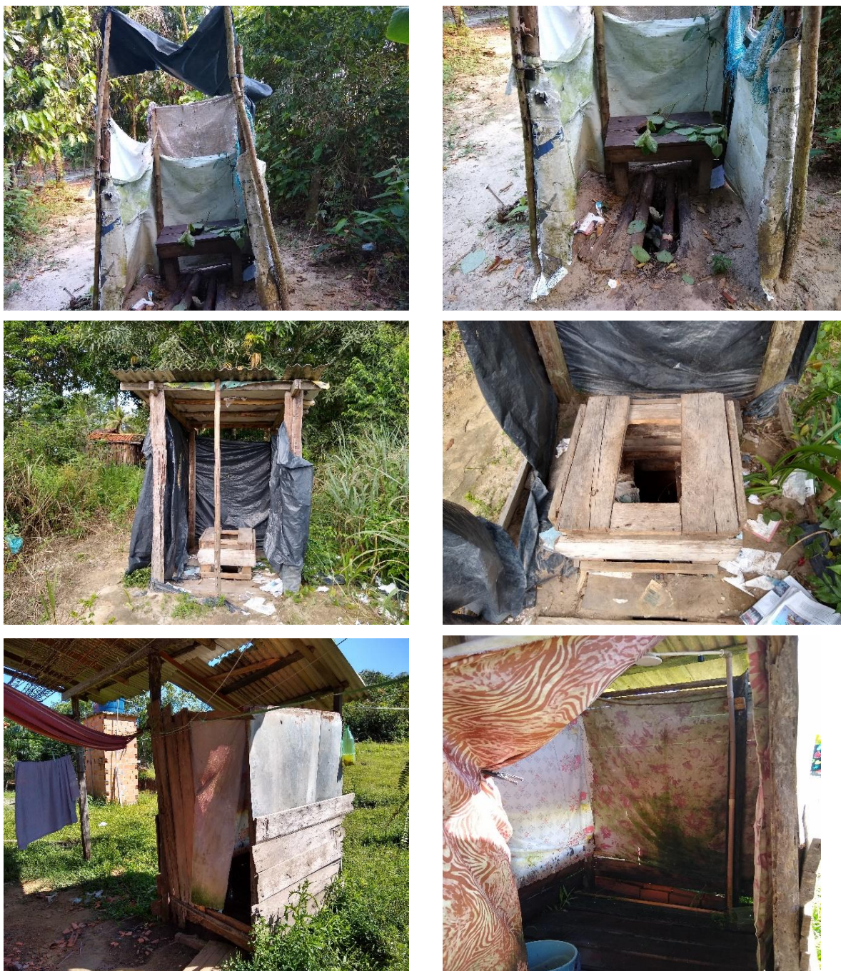
Figura 28: Exemplos de fossas rudimentares e banheiros usados por famílias do Quilombo São Pedro.
