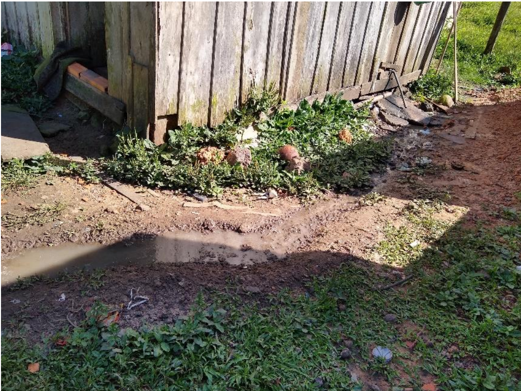
Figura 23: Esgoto doméstico sendo despejado no quintal A.
