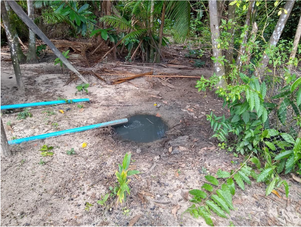
Figura 24: Esgoto doméstico sendo despejado no quintal B.
