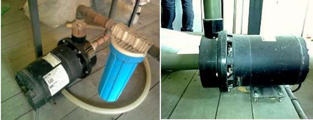
Figura 23 – Bombas de resfriamento do sistema.
