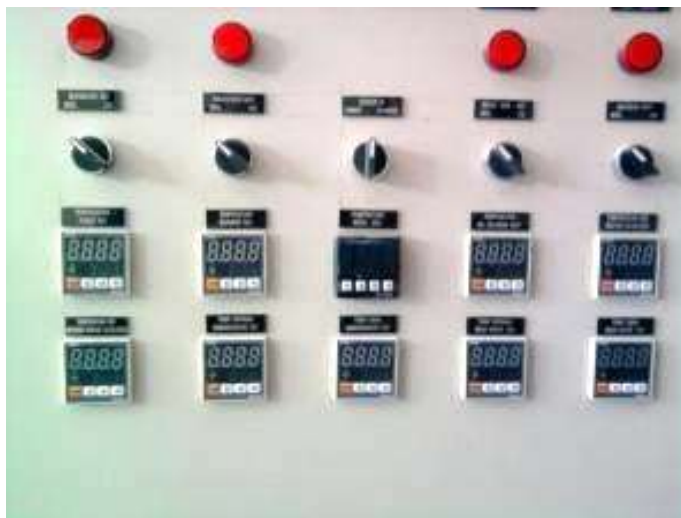
Figura 21 – Painel de Controle de temperatura (PID).
