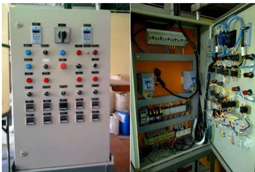
Figura 20 – Sistema de Controle Automatizado: visão externa e internamente.
