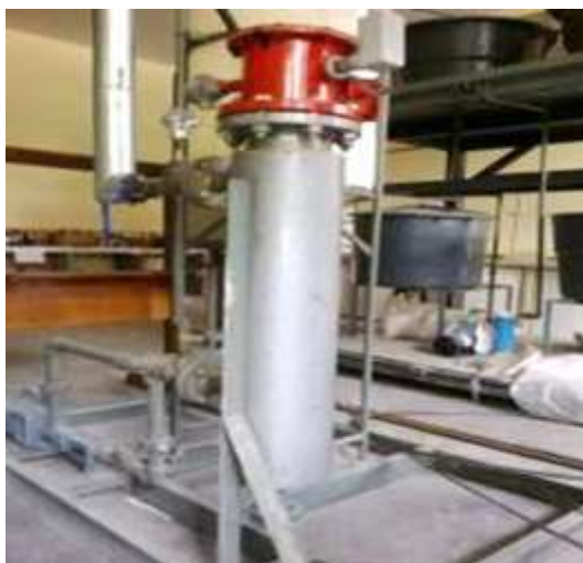
Figura 10 – Sistema de Pré-aquecimento.
