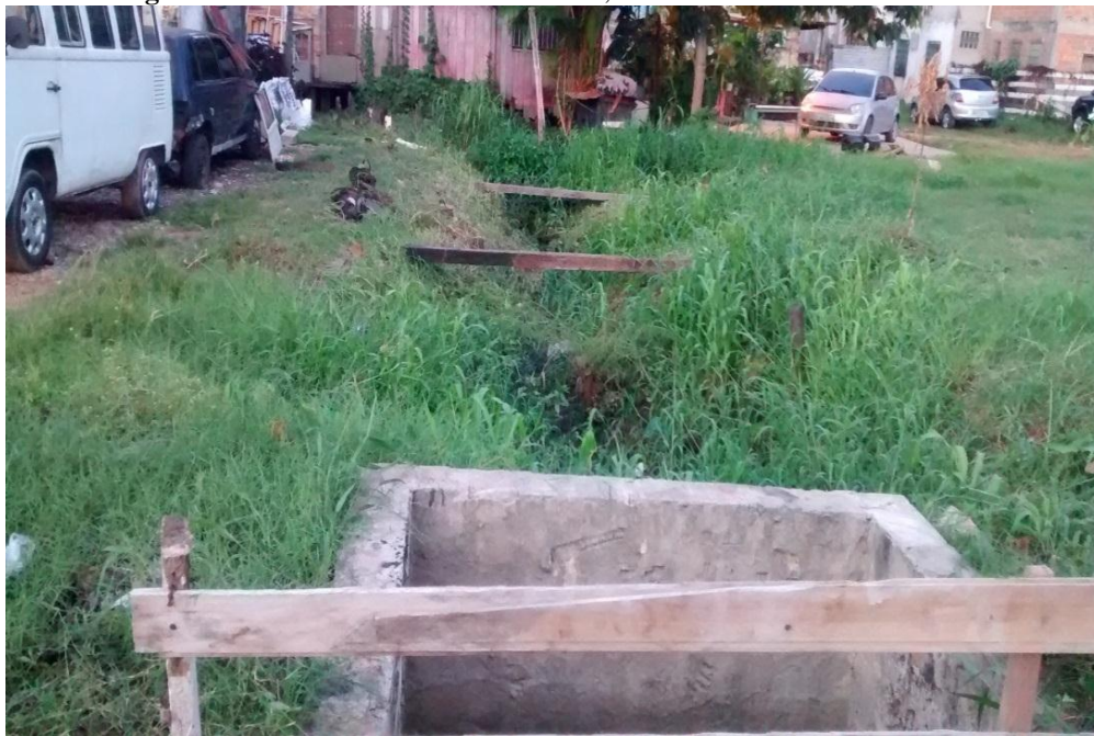
Fotografia 3 – Bueiros e Valas a céu aberto, Entrada Vila Passarinho e Valério.
