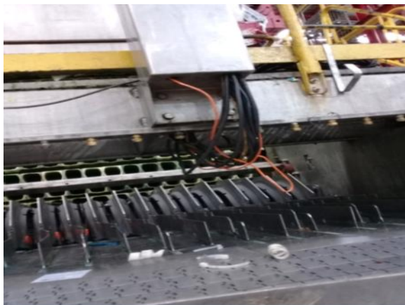
Figura 4.15 - Quadro elétrico aberto.
