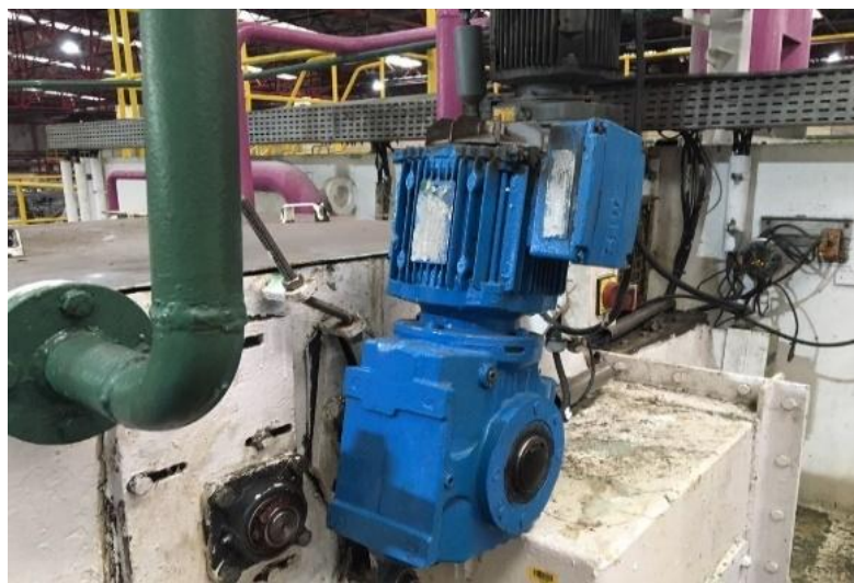
Figura 4.19 - Proteção da ventoinha quebrada.
