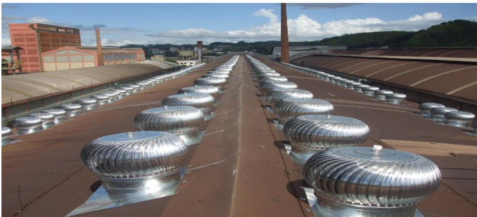
Figura 2.1 - Exaustores eólicos. Fonte: SOLUÇÕES INDUSTRIAIS (2021).
