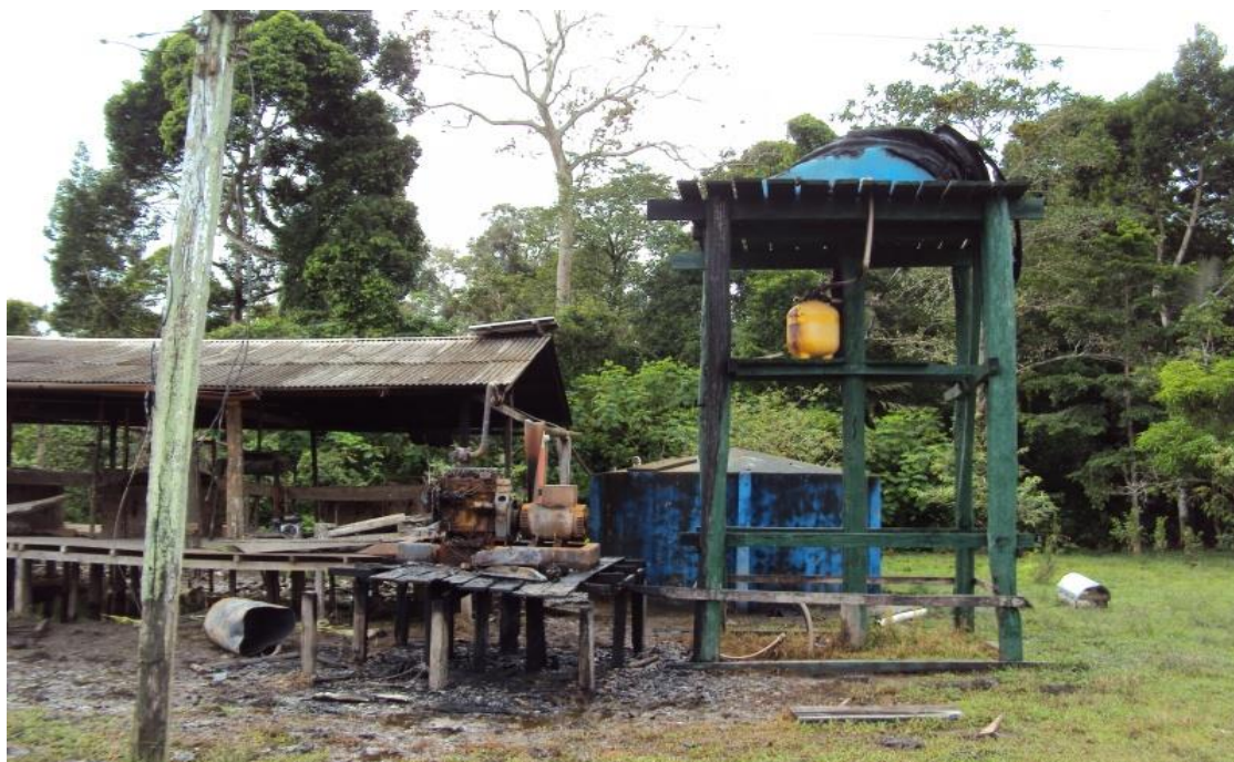
Figura 29: Sistema de água e gerador de energia na comunidade São Francisco do Aiucá após o incêndio causado por um curto circuito – 2011
