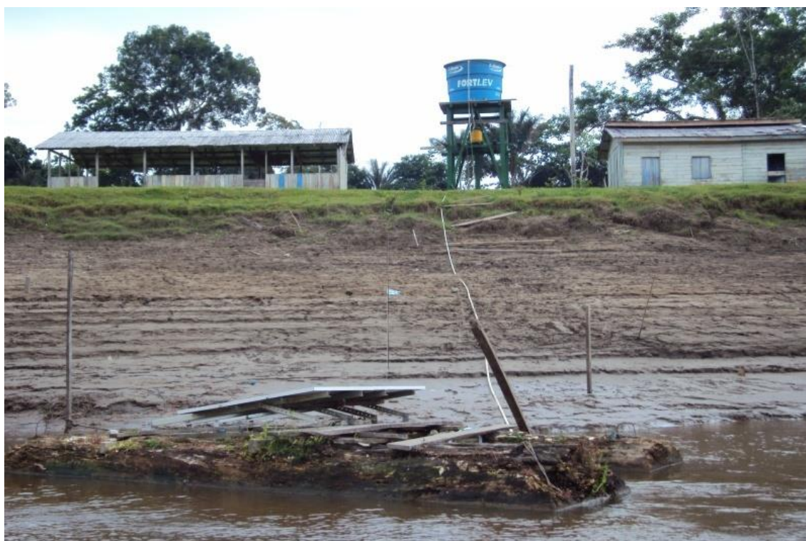
Figura 27: Sistema concluído e instalado com todos os componentes: placas solares, tubulação do rio à torre de distribuição, filtro de pré-tratamento da água e rede de distribuição para os domicílios.
