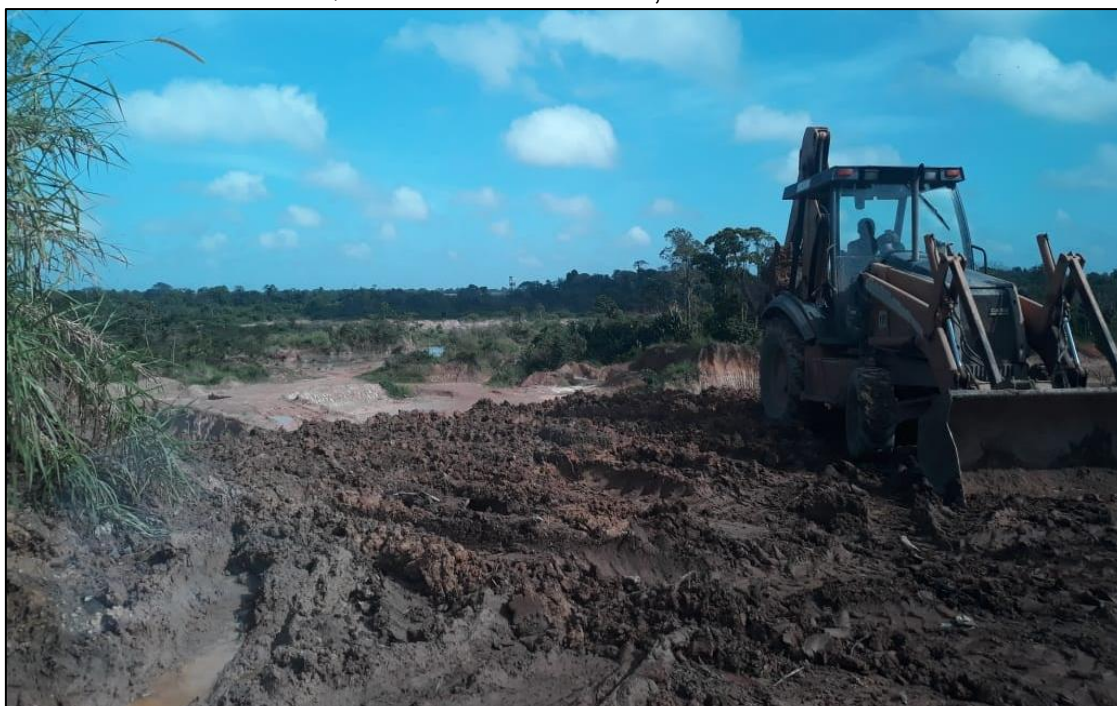
Figura 23: Curvões da retirada de aterro na estrada de acesso à Comunidade Quilombola do Abacatal, Ananindeua/PA.
