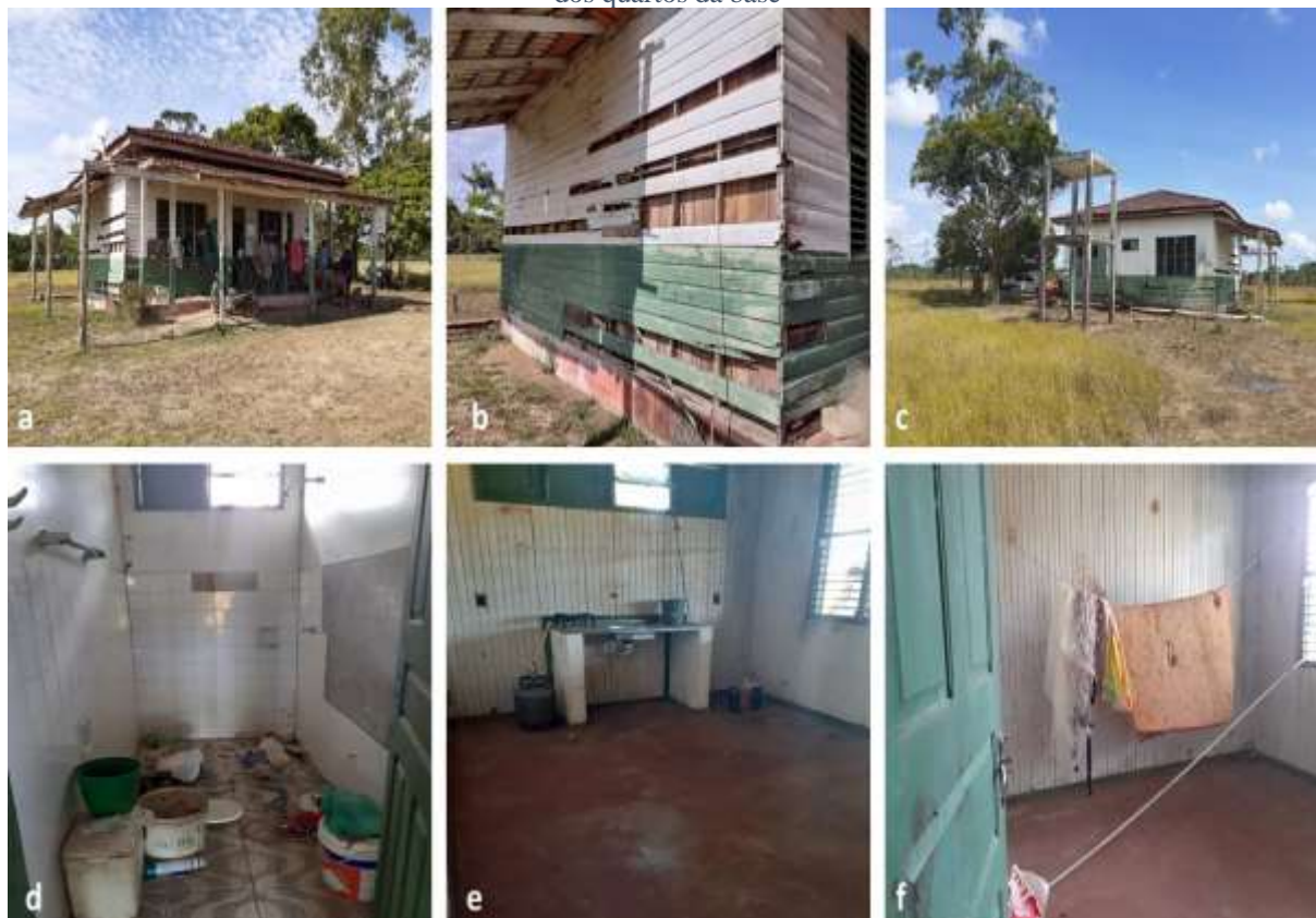
Imagem 39: a) vista parcial da frente da base com parte do telhado caído; b) situação das paredes da base; c) vista parcial dos fundos da base e da torre de caixa d'água vazia; d) banheiro da base; e) cozinha da base; f) um dos quartos da base
