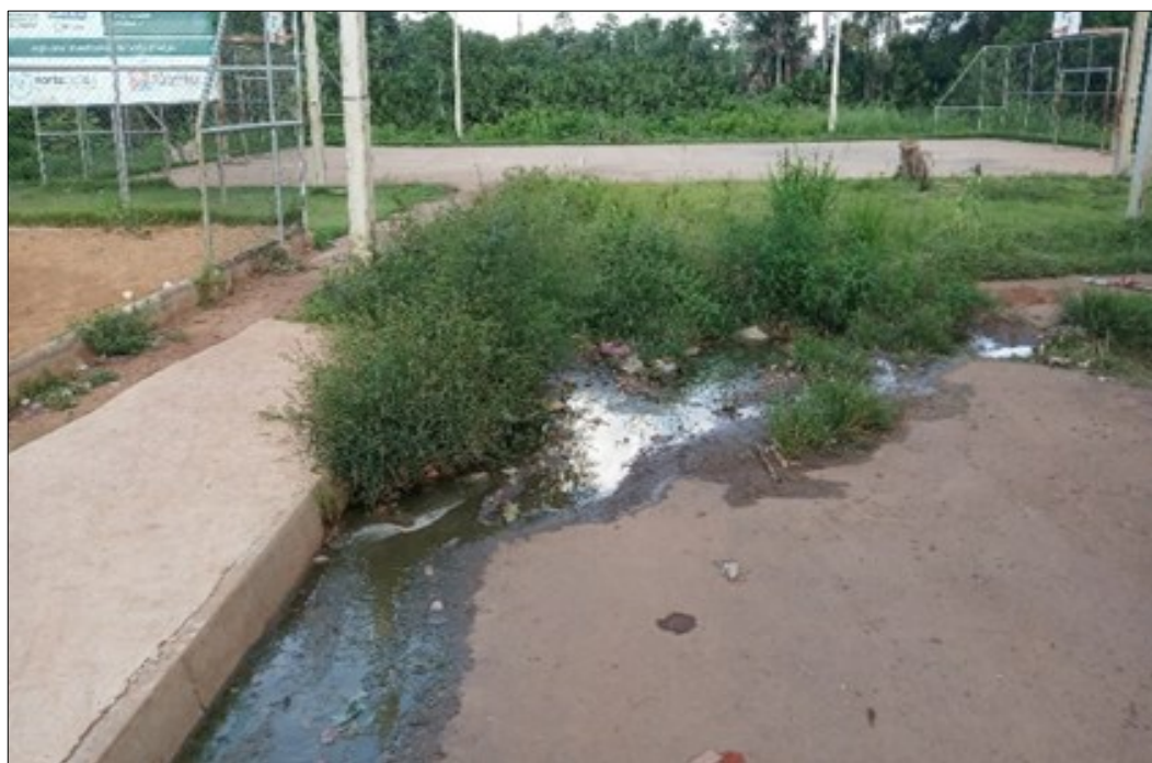
Figura 10 - Transbordamento de efluentes na EEE do RUC casa Nova Fonte: Foto tirada pelo autor durante o trabalho de campo 2020
