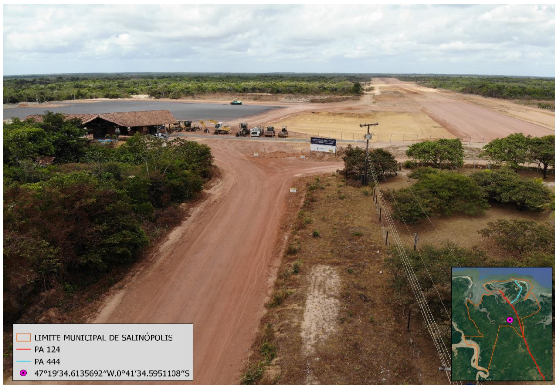
Figura 20: Obras do aeroporto de Salinópolis Fonte: Trabalho de campo realizado em outubro de 2019.
