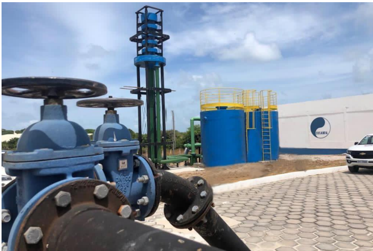
Figura 17: Estação de Tratamento de Água (ETA). Fonte: Imagem editada a partir de foto da SEDOP (2020).
