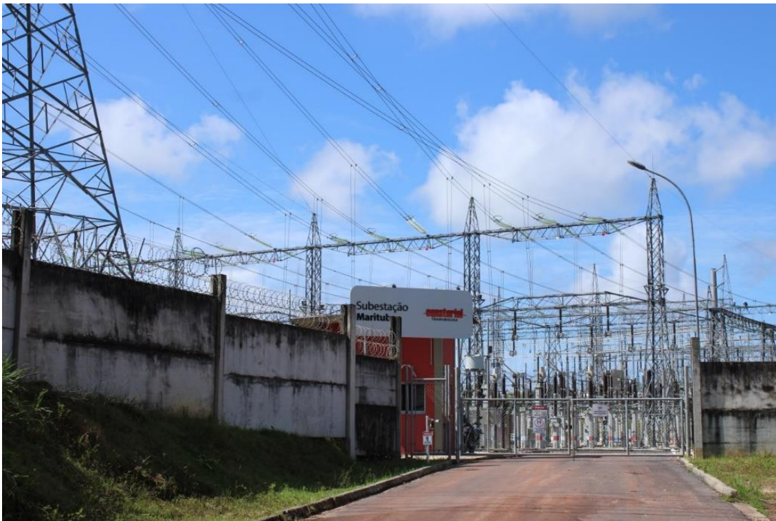
Foto 10: Subestação de energia de Marituba
