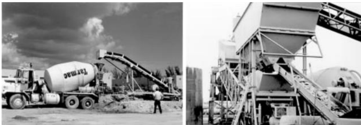
Figura 5.9 – Adição de fibras de aço no concreto através de esteira e dosador. FONTE: ACI 544.1R-96 (1996).
