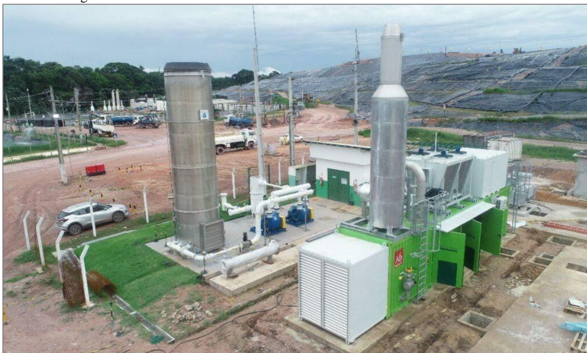
Fotografia 2: Termelétrica movida a RSU instalada no Aterro Sanitário de Marituba.
