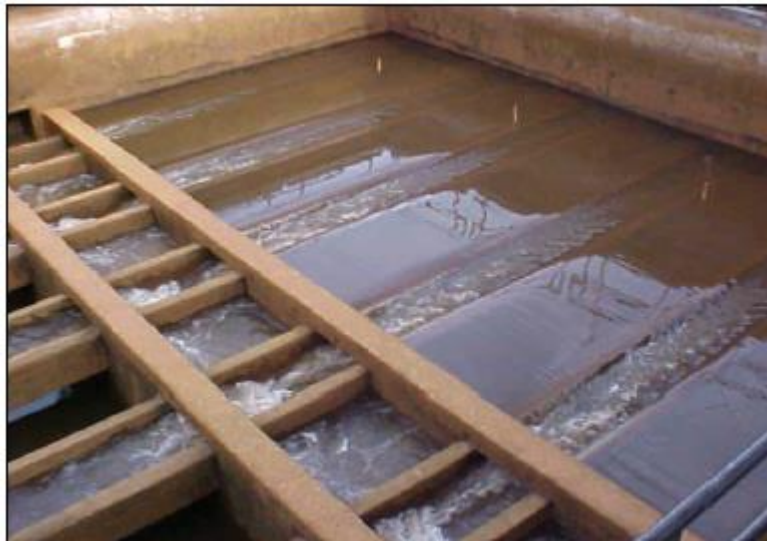
Figura 11 – Lavagem de uma câmara de filtro da ETA Bolonha. Fonte: Machado, 2003.
