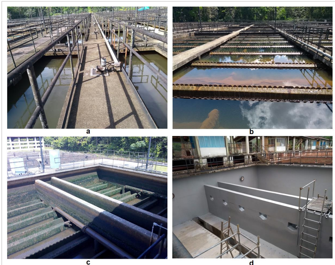
Figura 10 – Floculadores (a), decantadores (b) e filtro da 2ª etapa (c) e filtro em reforma da 1ª etapa da ETA Bolonha (d).
