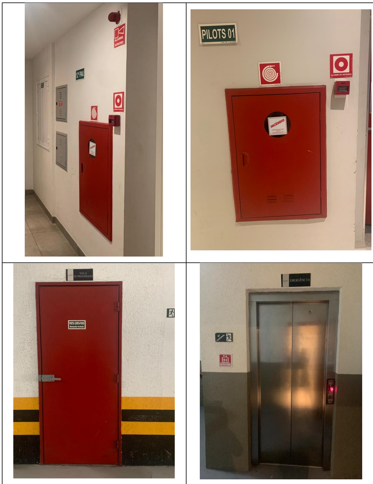
Figura 23 – Ilustração dos equipamentos de segurança do edifício B
