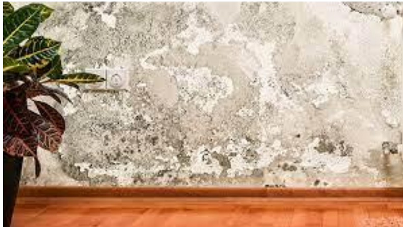
Figura 5 - Parede com umidade
