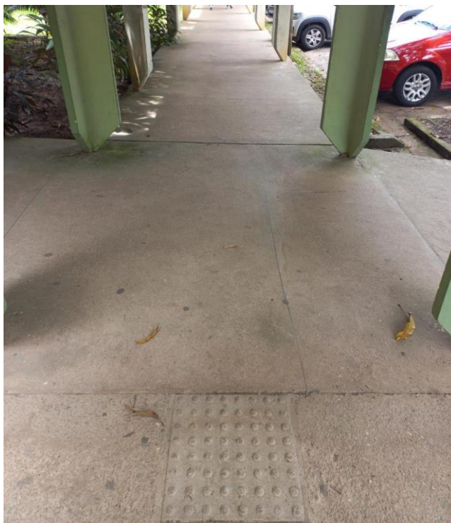
Imagem 28 – Corredor sem piso tátil contínuo
