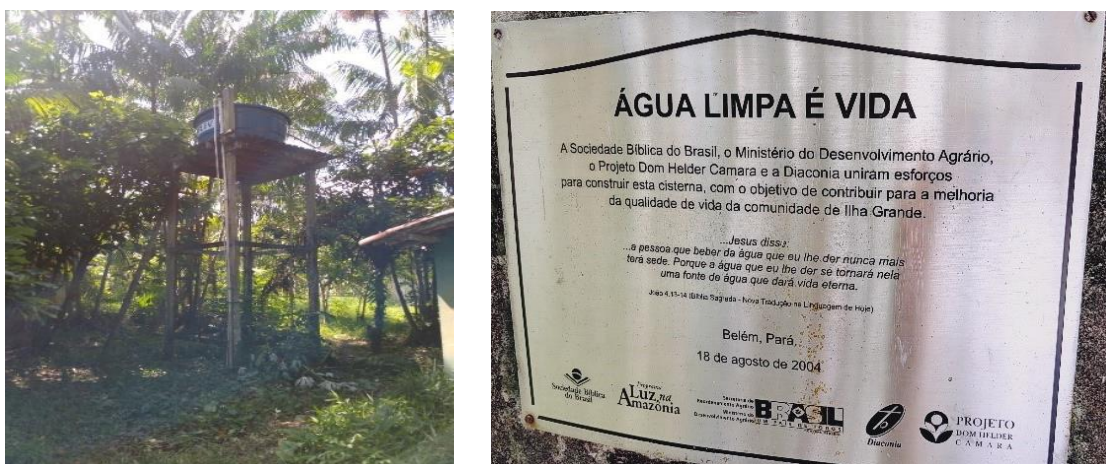
Fotografia 16 – Estrutura e caixa d'água para armazenamento de água, ilha Grande, Belém, Pará.
