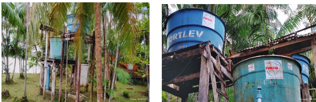
Fotografia 18 – Sistema de captação de água, ilha do Maracujá, Belém, Pará.
