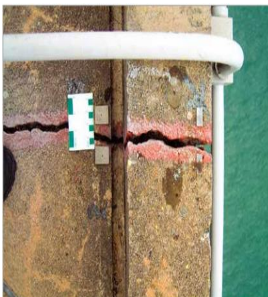
Figura 6 - Reação álcali-agregado em viga e laje de uma barragem.
