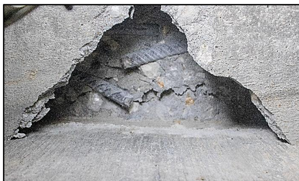
Figura 4.15 – Possível desdobramento da armadura (Autora, 2023).
