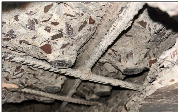
Figura 4.14 – Ruptura por arrancamento do cone de concreto, SS0 (Autora, 2023).
