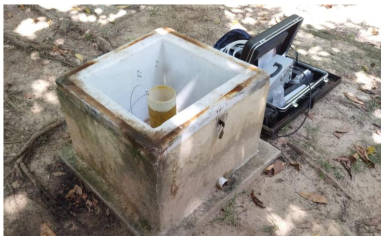
Figura 17- Estado de conservação do PM-02.
